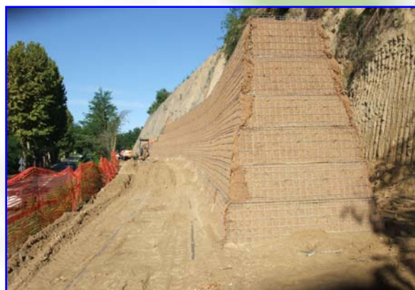
Foto 3 – Impiego del sistema preassemblato FAST-TER® nella realizzazione di un rilevato paramassi ad alto angolo (80°)
