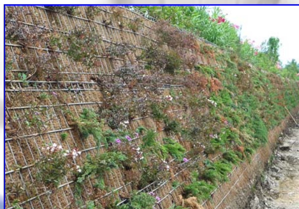
Foto 4 – Impiego del sistema preassemblato FAST-TER® nella realizzazione di una barriera visiva e fonoassorbente
