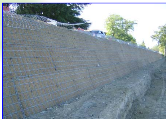
Foto 2 – Impiego del sistema preassemblato FAST-TER® nella realizzazione di un allargamento stradale di sottoscarpa
